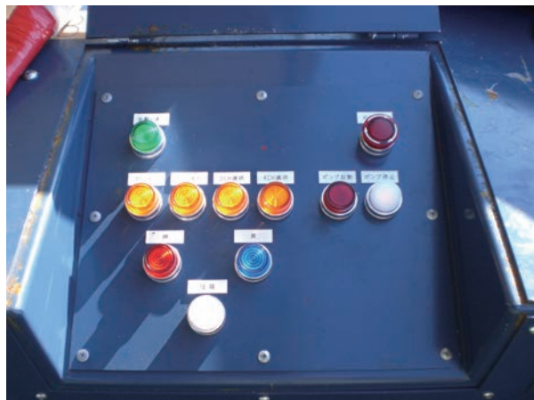
ポンプ操作パネル
